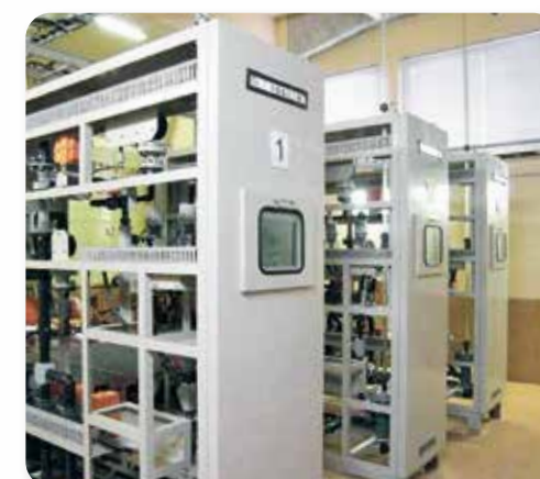
次亜塩注入設備
