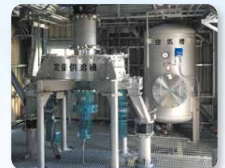
粉末活性炭注入設備
