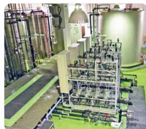
薬品注入設備
